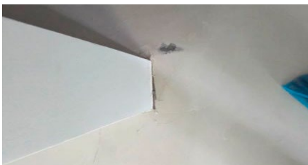
Eksempel: Ujævnheder i underlaget øger risikoen for gennemslibning af StyleFloor.
